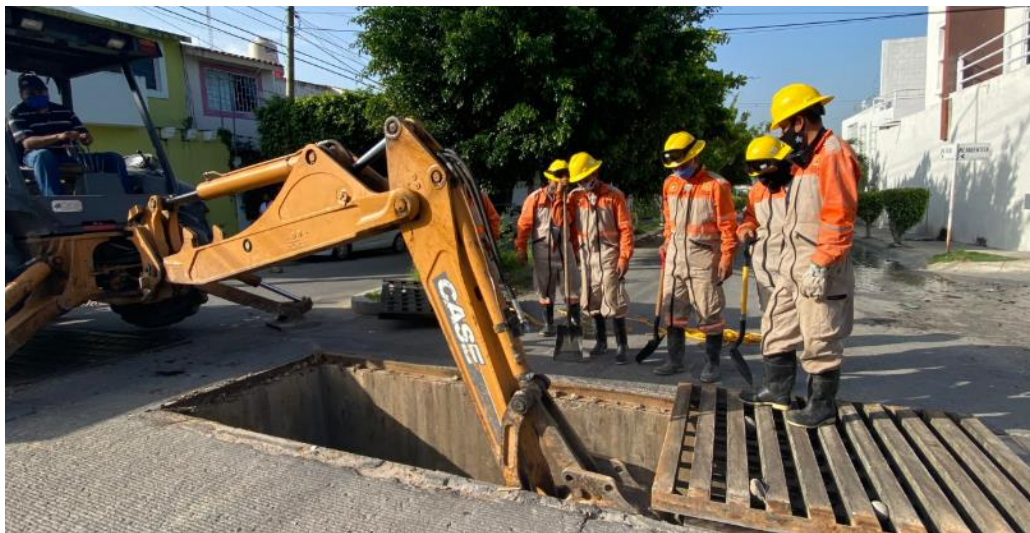
Acciones requeridas: Desazolve de alcantarillas.
